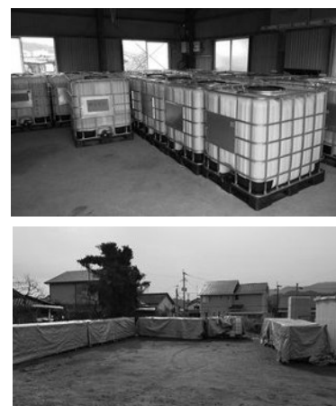
図1 発酵兼貯留タンク (上段：屋内，下段：屋外)
